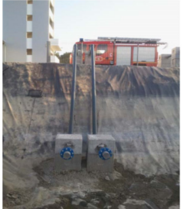
Deux colonnes de 100 mm sur une réserve d'eau ouverte
