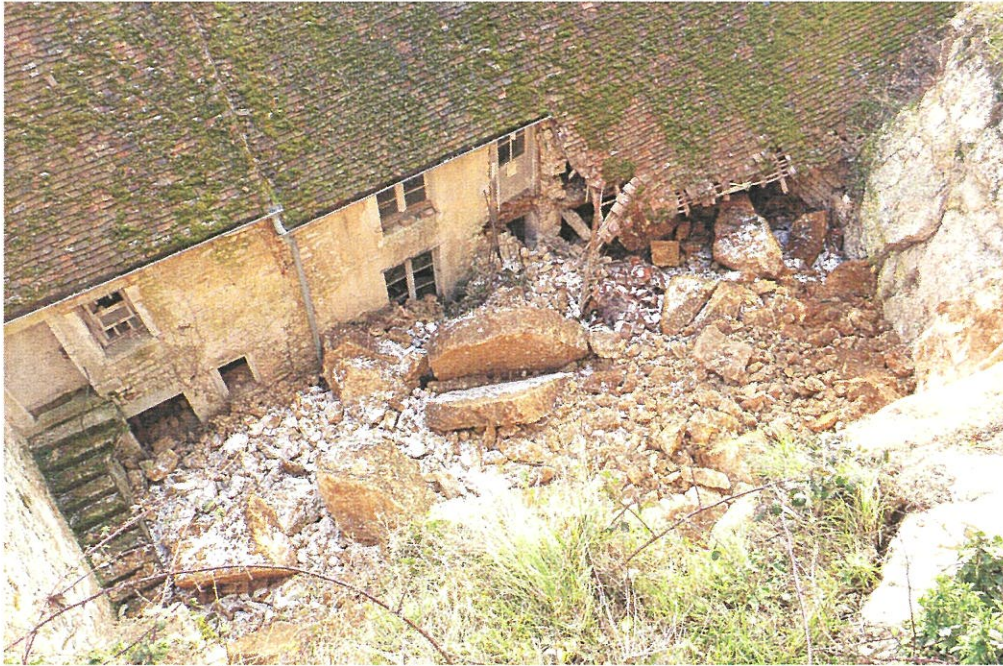
Illustration 16 : Éboulement du 17 février 2013 à Pesmes (70)
