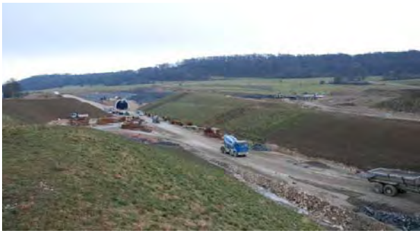
Configuration susceptible de créer un effet de site topographique à Chavanne (70), tête du tunnel de la LGV Rhin-Rhône dimensionné pour ce phénomène (photo BRGM).
