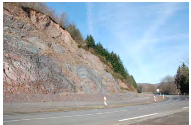
Risque d'éboulement le long de la RD4 (70) (photo BRGM).
