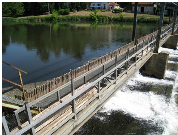
Le barrage mobile et ses aiguilles de bois.
